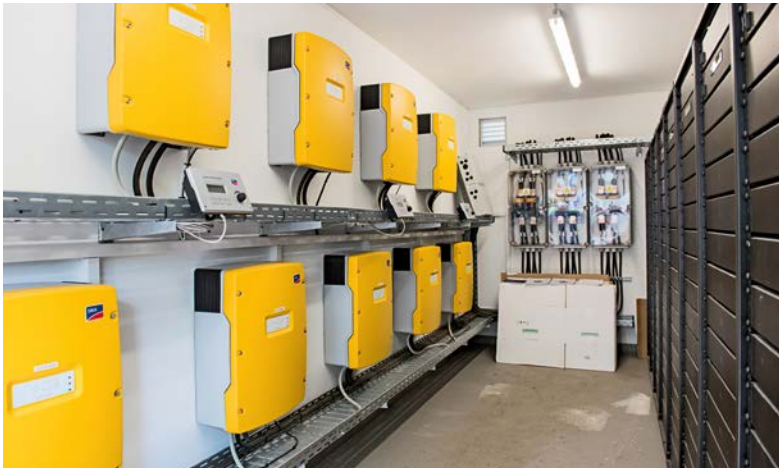
In den schwarzen Batteriespeichern wird überschüssiger Solarstrom zwischengespeichert
