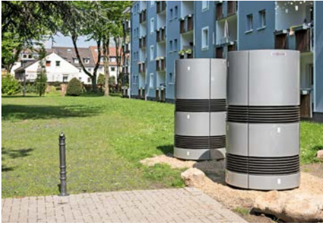
Hinter diesen silbergrauen Rundsäulen verbergen sich die Ansaugstutzen für eine der Luft-Wärme-Pumpen
