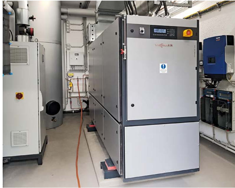
Wärmezentrale mit BHKW, Batteriespeicher sowie smarter Regelungstechnik der PV-Anlage in Mülheim
