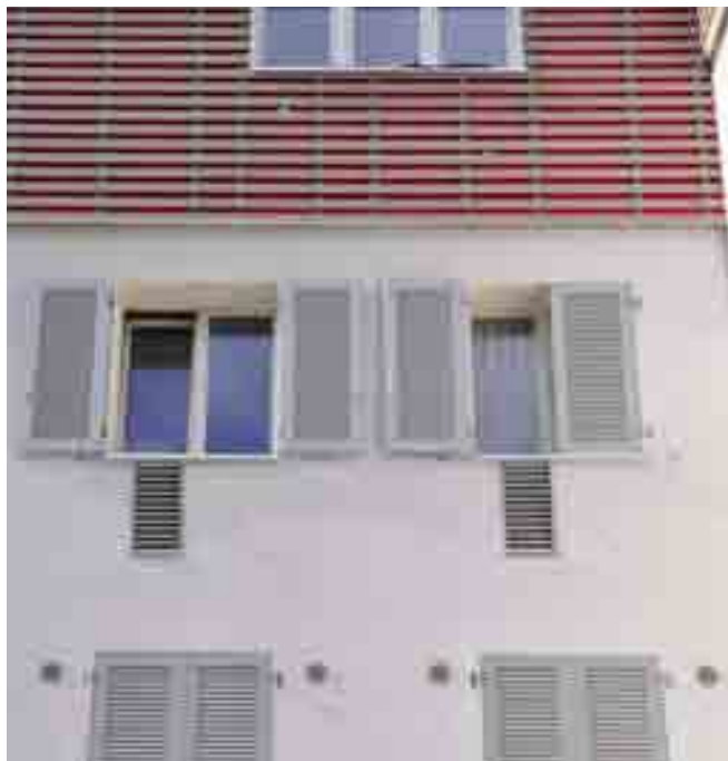
Durchbrüche in der Wand führen die Frischluft zu und die Abluft ab. In der Ankengasse untersuchten die Beteiligten verschiedene Lösungen der Zu- und Abluftgestaltung. Die runden Luftauslässe sind bei geöffneten Fensterläden verdeckt.
