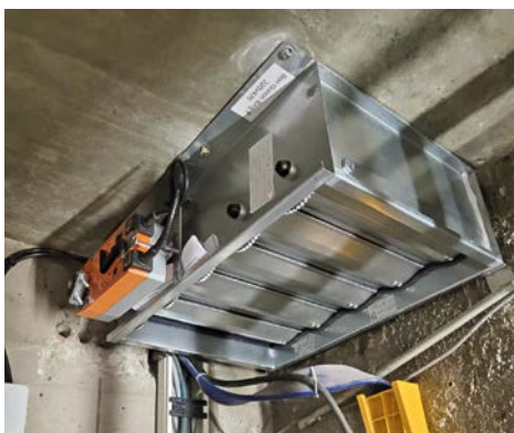
Entrauchungsklappen dienen der Absaugung von Feuer und heißen Gasen sowie der gezielten Frischluftzufuhr in Brandabschnitten
