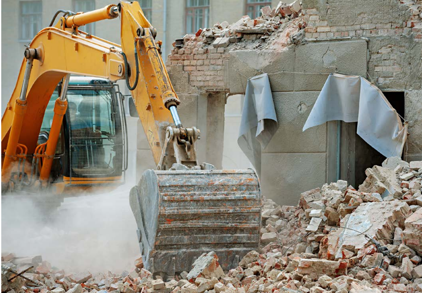
Sind Gebäude vor Ablauf der Nutzungsdauer technisch oder wirtschaftlich verbraucht, werden sie in der Regel abgerissen. Unter bestimmten Umständen wird der Nachweis einer kürzeren Nutzungsdauer steuerlich relevant
