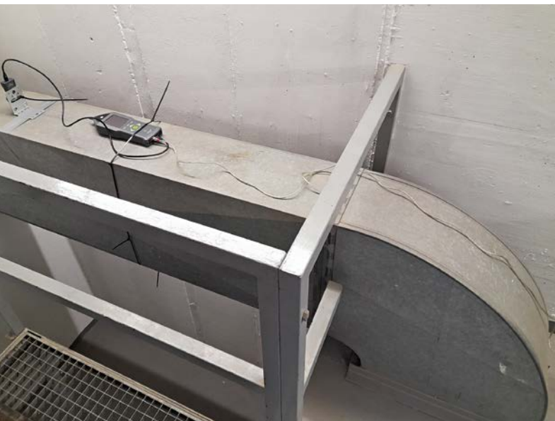
Die Erfassung der Lüftungsverluste im Entrauchungskanal
