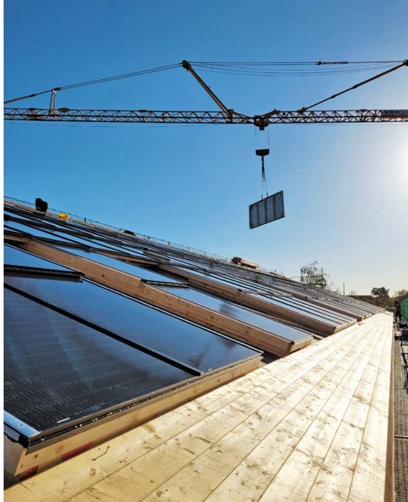
Eine entscheidende Rolle für das Energiekonzept spielen die Photovoltaikmodule auf dem Dach und an den Fassaden
