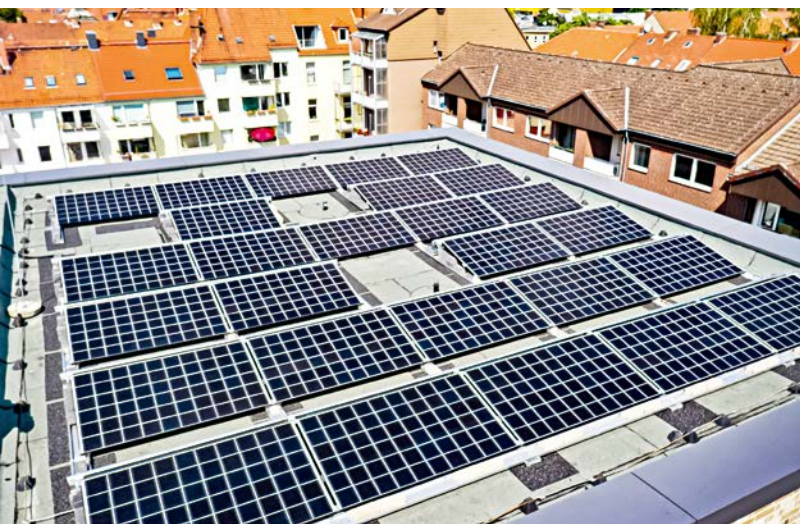
Photovoltaikanlage auf dem Dach der Hauptverwaltung der Spar- und Bauverein eG in Hannover: Auch für solche Investitionen können Gelder der Spareinrichtung verwendet werden
