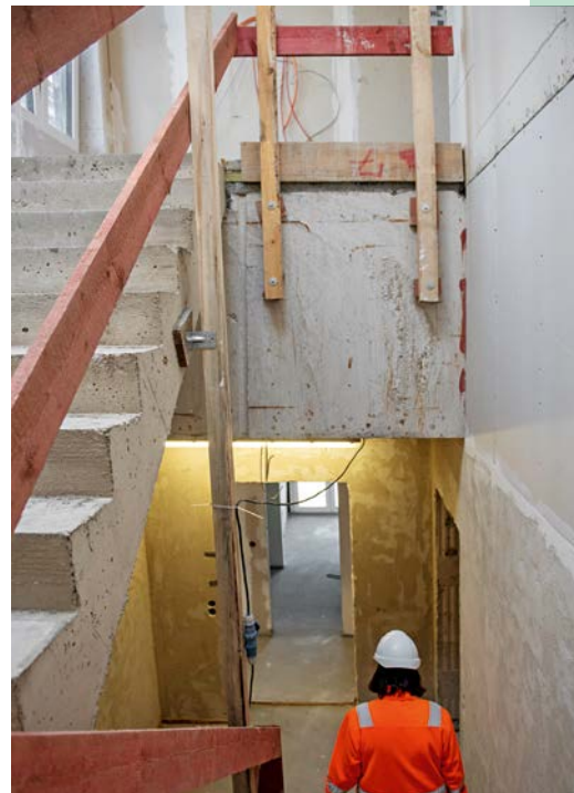
Die 1,40 m starke Bunkerdecke, durch die die Treppe ins Staffelgeschoss führt, erinnert an die frühere Nutzung
