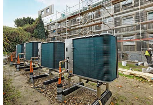
Die zentralen Luft-Wärmepumpen sorgen für ausreichend Leistung, um den Bestand an der Wichernstraße mit Wärme zu versorgen
