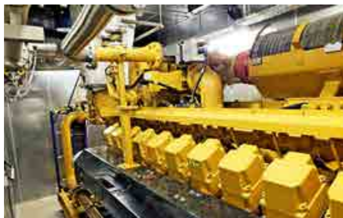
Das BHKW in Orschel-Hagen von außen (oben) und innen
