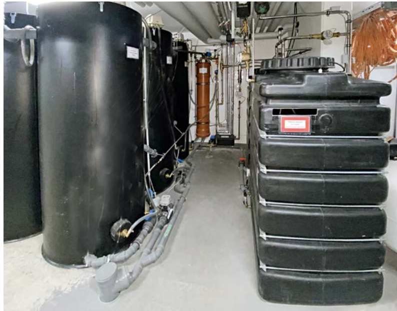
Blick auf die Grauwasseranlage der EWG Berlin-Pankow in der Dolomitenstraße
