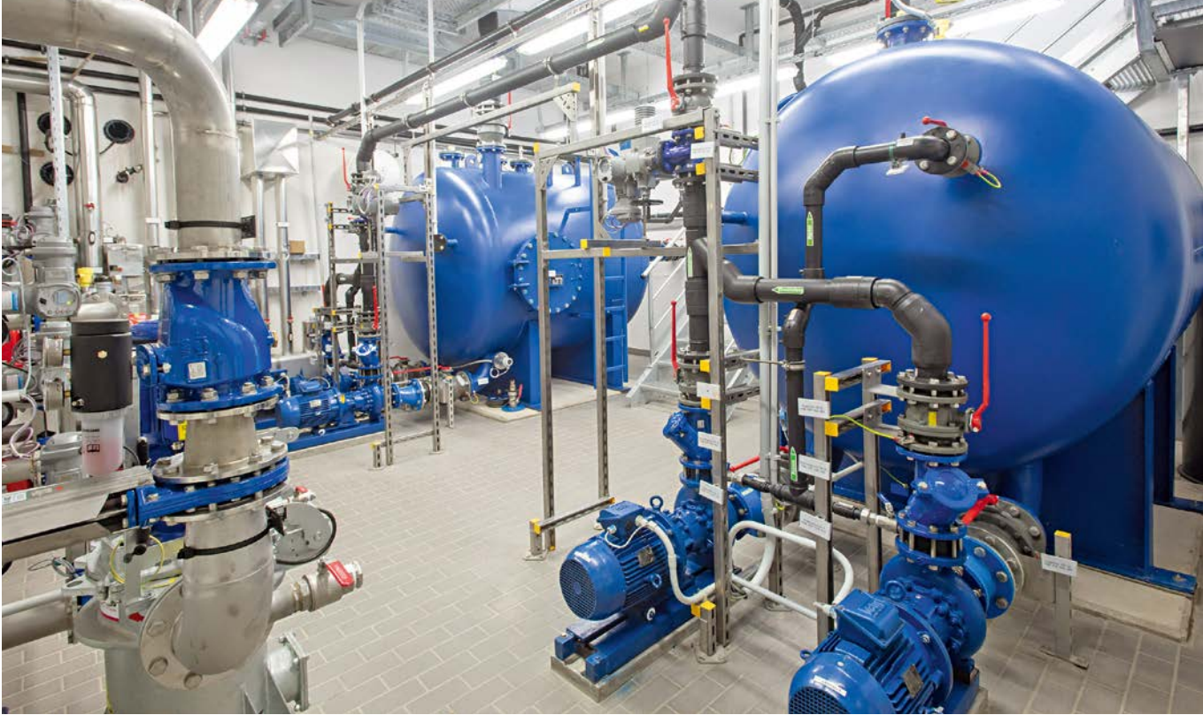
Das Abwasser aus den Toiletten wird mittels Vakuumpressoren abgesaugt und über ein gesondertes Leitungsnetz zur Weiterverarbeitung in den Betriebshof von Hamburg Wasser weitergeleitet
