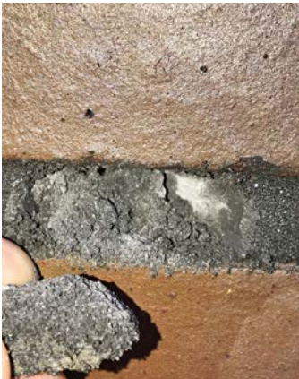
Bild 5: Der Querschnitt eines nicht fachgerecht verdichteten und somit haufwerksporigen Fugenmörtels. Der Mörtel ist „verbrannt“
