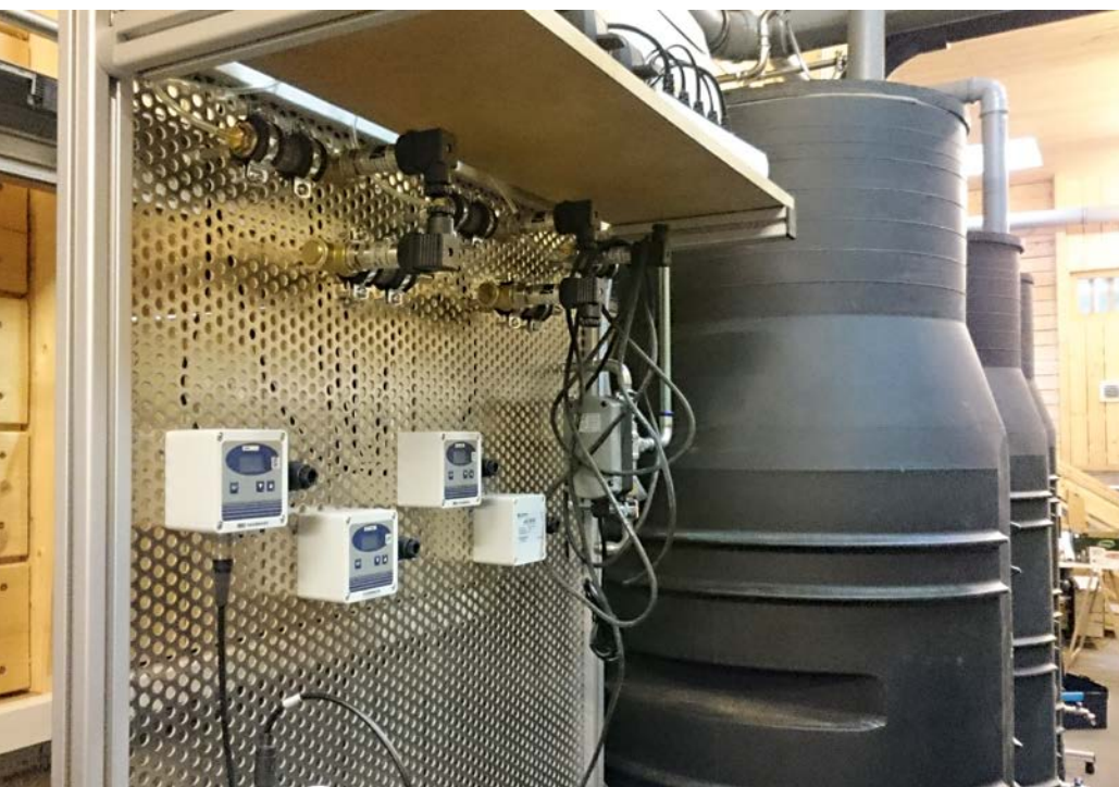
Anlage zur Nutzung des Schwarzwassers in Berlin-Kreuzberg
