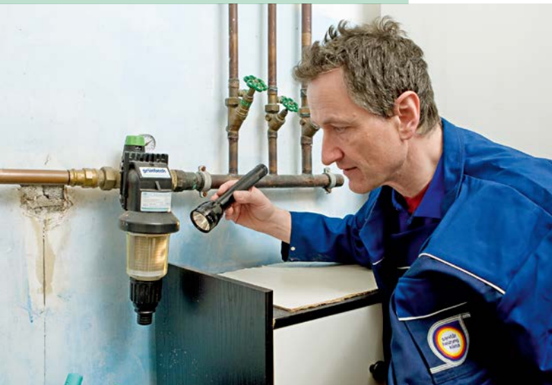
Eine regelmäßige Überprüfung und Wartung ist bei Trinkwasseranlagen in der Wohnungswirtschaft immer zu empfehlen
