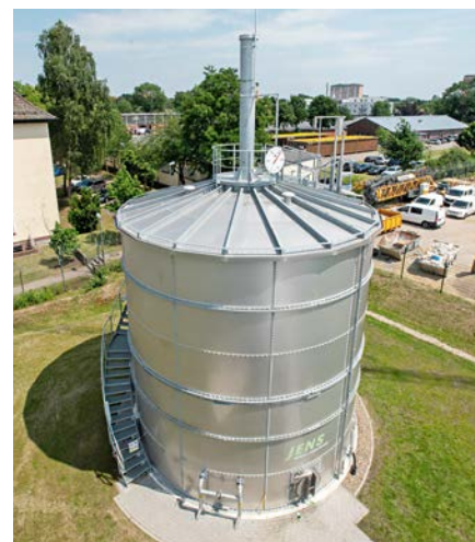
Im Fermenter der Biogas-Anlage auf dem Betriebshof wird das Schwarzwasser, das sich aus Kot, Urin, Toilettenpapier und Spülwasser zusammensetzt, zu Methangas
