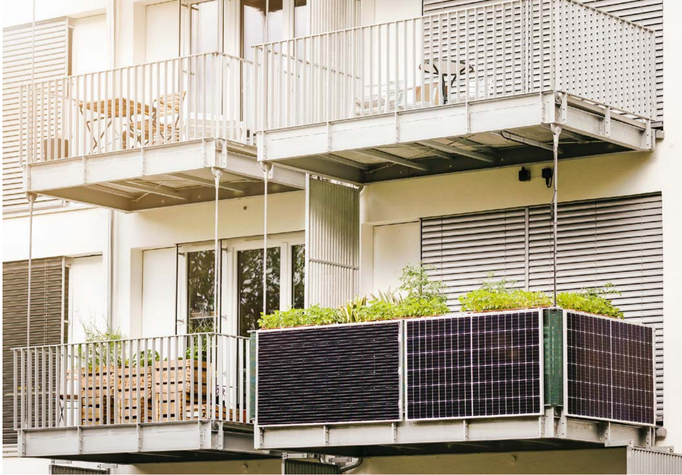
Kleine Solaranlagen, die sich auf dem Balkon installieren lassen, werden immer beliebter bei Mietern. Für die Einrichtung gelten im Vergleich zu größeren Solaranlagen vereinfachte Regeln, doch auch hier gilt es einiges zu beachten
