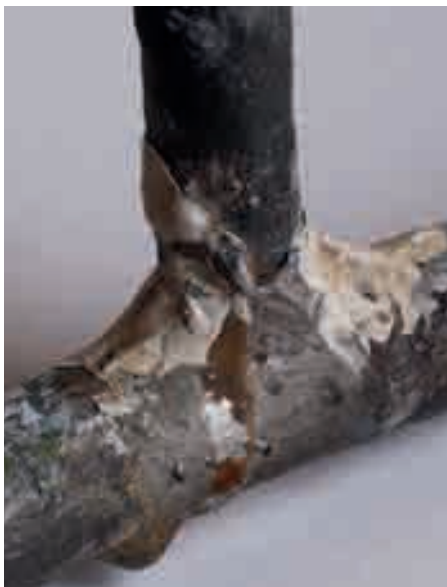
Abzweigung an alter Bleileitung
