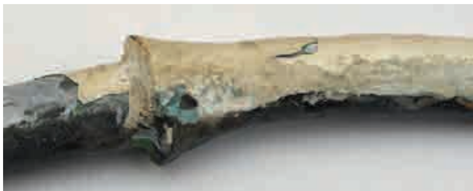
Die Rohrenden sind ineinander geschoben und dort tulpenförmig verlötet. Farbanstriche (hier weiß) haften nur sehr schlecht auf Blei
