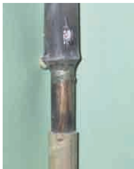
Im Rahmen einer zurückliegenden Teilsanierung wurde hier eine alte Bleileitung (oben) mit einer Kupferleitung (unten) verbunden
