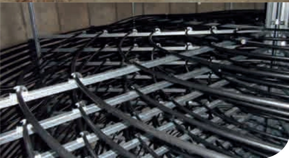
Der Einsatz von Eisspeichern ist heutzutage keine ganz neue Idee mehr. Im Inneren des mit Wasser gefüllten Behälters befinden sich Kunststoffleitungen, die mit einem Glykolgemisch befüllt sind, welches als Katalysator dient und Wärme abgibt oder aufnimmt
