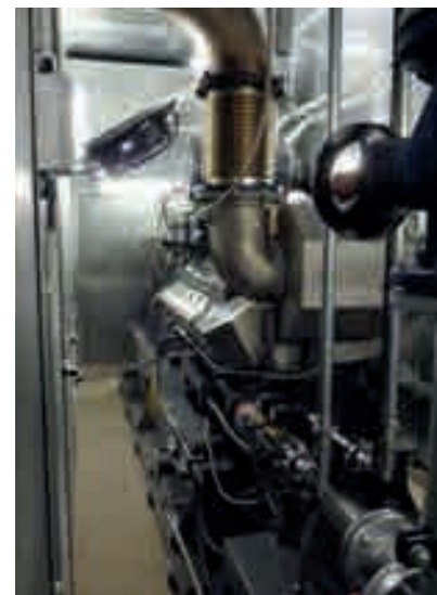
Der Verbrennungsmotor ist das Herz des BHKW: Er treibt den Generator an, der Strom und gleichzeitig Wärmeenergie produziert
