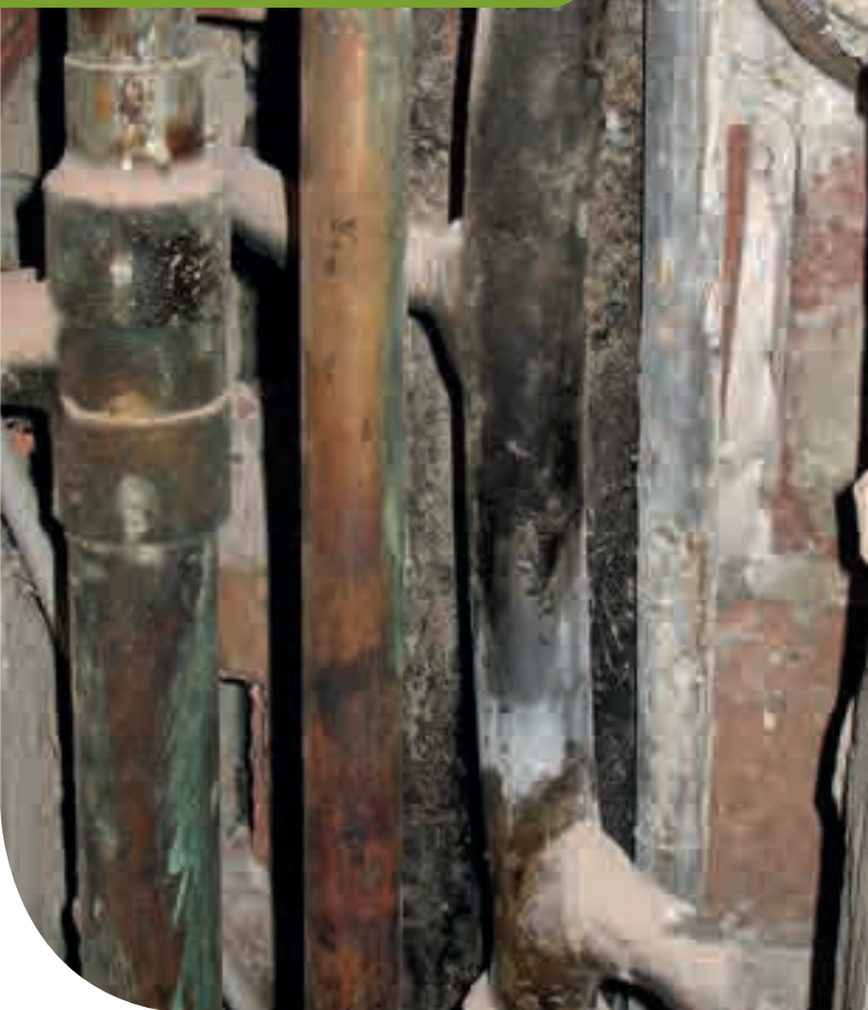
Steigleitung aus Blei (rechts) neben Rohren aus anderen Materialien
