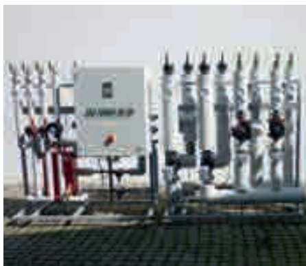
Quelle: Neuwoges Neubrandenburger Wohnungsgesellschaft mbH Stein des Anstoßes: Hausanschlussstation für Fernwärme
