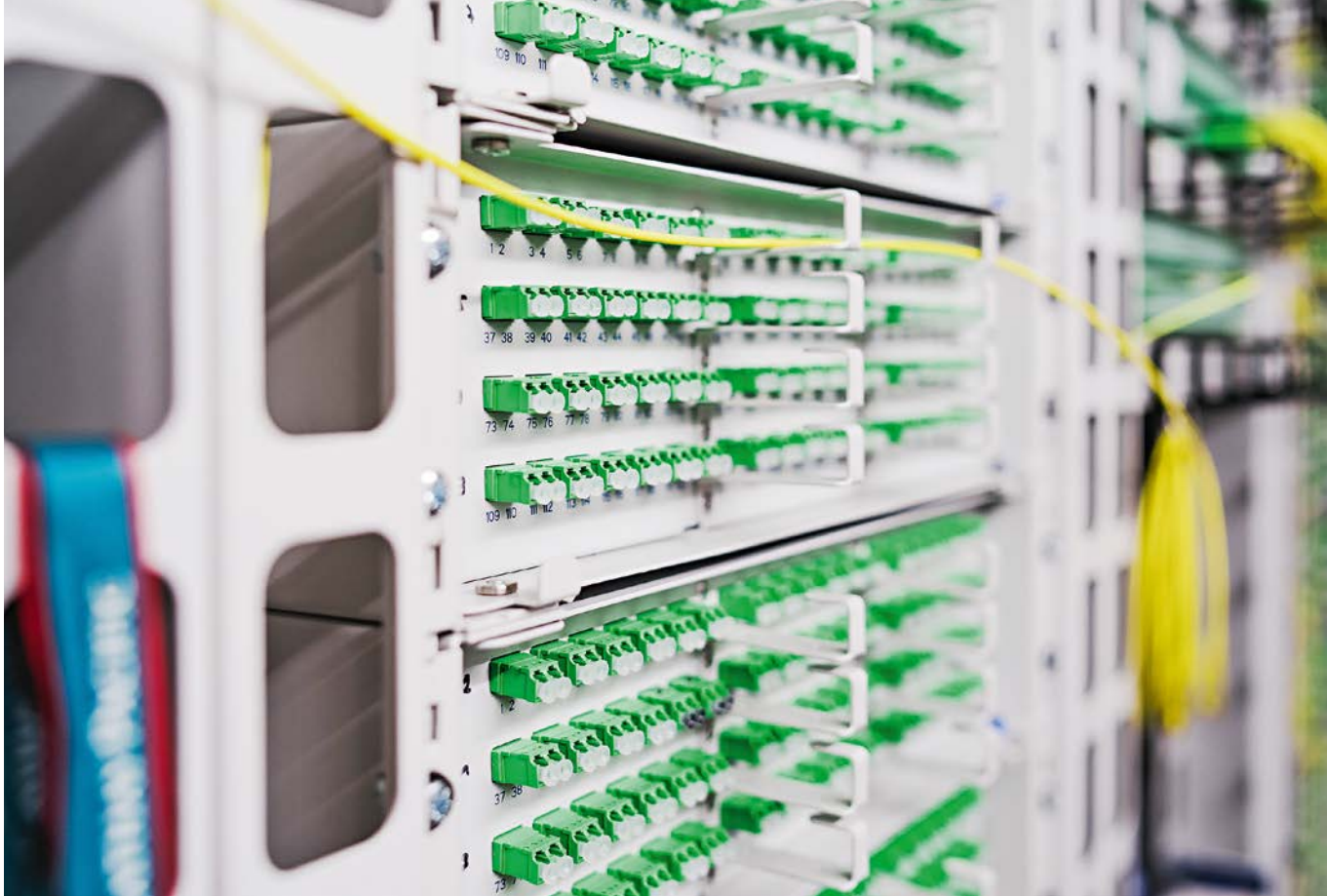
Ein Pluspunkt bei der TV- und Radioversorgung via Satellit ist die Zuverlässigkeit des Empfangssignals. In Radolfzell versorgt die Baugenossenschaft Hegau eG ihre Gebäude über eine Empfangsanlage mit drei Verteilkästen per Glasfasernetz mit Satelliten-TV und Internet
