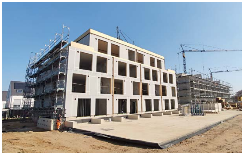
Aufgrund Pandemie-bedingt hoher Holzpreise kam eine Hybridbauweise mit fertig gedämmten Fassadenelementen aus Holz zur Ausführung
