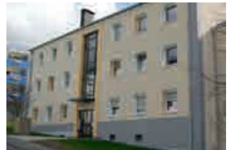
Vor der Fassadensanierung haben manche Gebäude durch ein starkes Gefälle ihre Basis verloren. Dieses Problem wurde durch zusätzliche Bossen über dem Erdsockel gelöst
