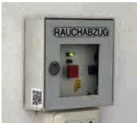
QR-Code: Anbringung im Gebäude, hier für den Rauchabzug
