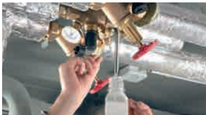
Legionellenprüfungen des Trinkwassers
