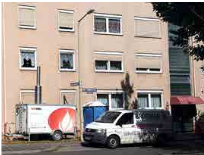
Die mobile Heizzentrale
