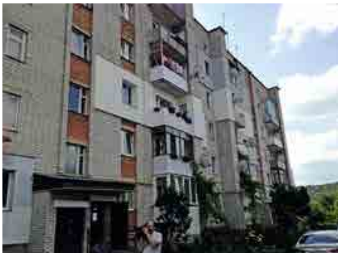
Ansicht des Wohnhauses Yarvonickovo Str. 8 im Modellprojekt Zhovkva. Ein typisches Beispiel mit in Eigeninitiative gedämmten Fassadenbereichen und Fenstererneuerungen durch die Wohnungseigentümer
