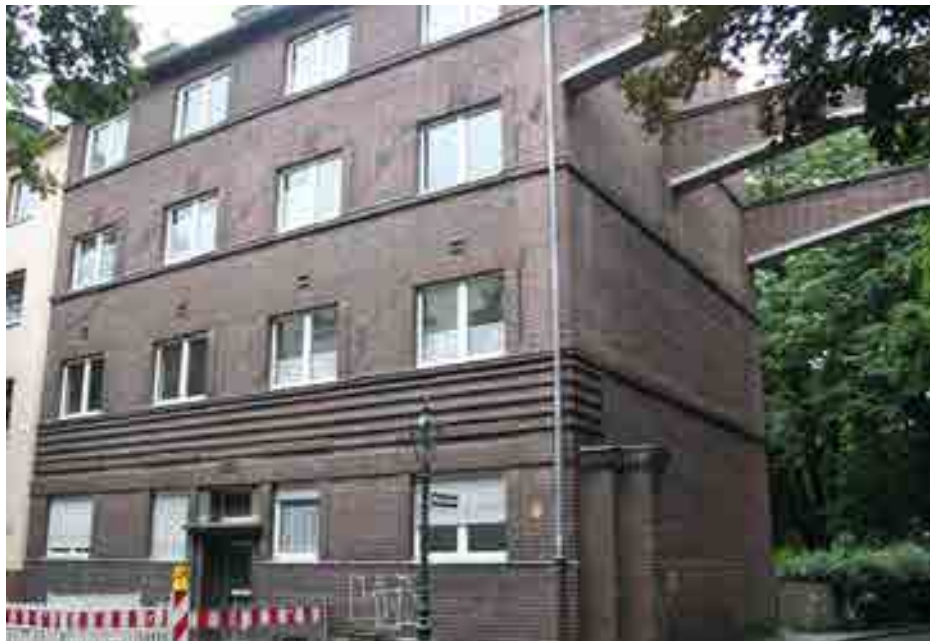
Der seit den 1980er Jahren denkmalgeschützte Klinkerbau in der Merkurstraße wies große Baumängel auf. Schon früh musste er zum Nachbarhaus abgestützt und schließlich zwecks Abriss leergezogen werden, Foto von 2007
