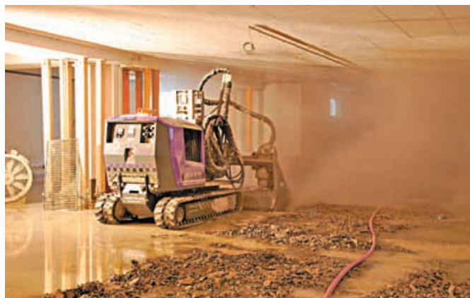
Bild 2: Beispiel Betonabtrag Bodenfläche
