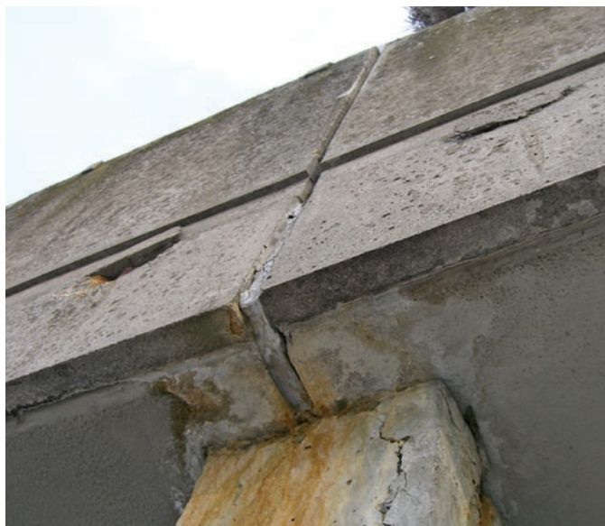
Schaden durch geringe Bewehrungsüberdeckung
