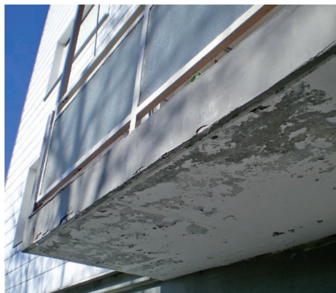
Schaden durch Undichtigkeit
