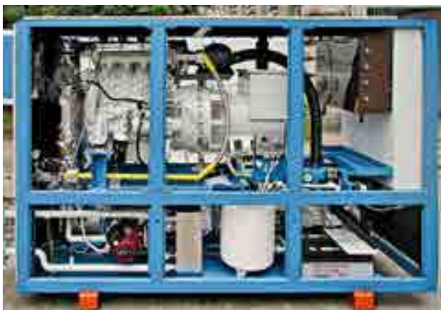
Blockheizkraftwerk zur Versorgung eines Wohngebäudes
