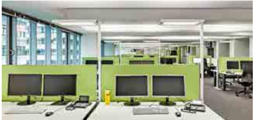
Bei der Einrichtung von Arbeitsplätzen sind beim Licht wesentliche Normen zu beachten. Diese Installation im Pressehaus Stuttgart folgt zudem den Grundsätzen der biodynamischen Beleuchtung.
