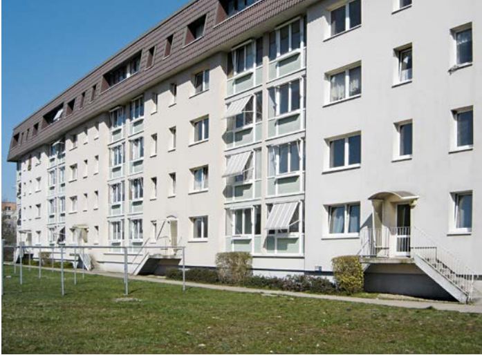
Früher führten auf der Rückseite Treppen zu den Grünflächen. Das beim Rückbau der zwei oberen Geschosse gewonnene Material diente dann dem Aufschütten von Rampen und einer barrierefreien Erschließung
