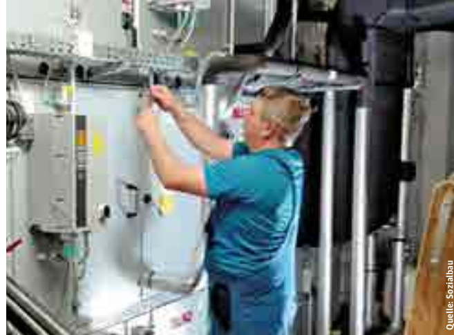
Online gesteuerte Heizanlagen und Monitoring reduzieren den Energieverbrauch
