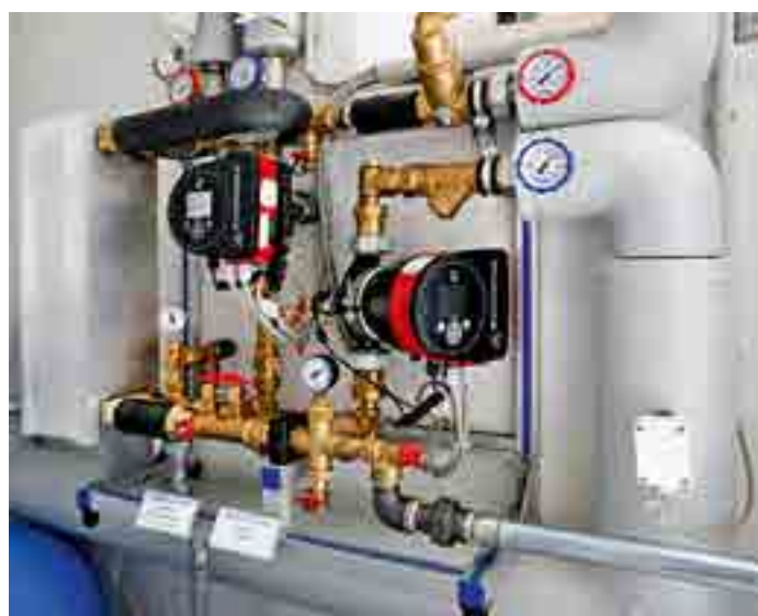
In einem Übergabesystem wird die Solarwärme in die Speicher eingespeist
