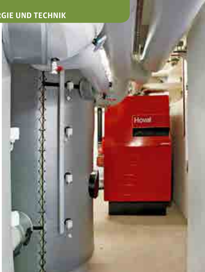
Ein gasbetriebener Spitzenlastkessel erbringt 450 kW an thermischer Energie
