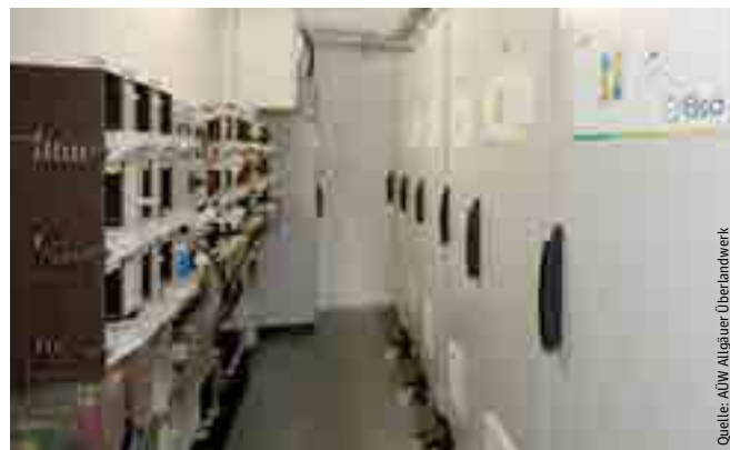
Beim Mieterstromprojekt „Auf dem Bühl“ wird der Strom in einer Großbatterie gespeichert
