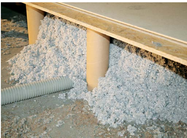
Begehbare Dämmung der obersten Geschossdecke mit der Dämmhülenskonstruktion ( d=36 \text{ cm} ) mit Zellulose
