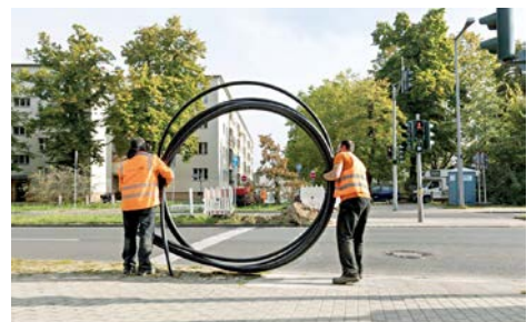
Der GdW befürchtet, dass der Netzausbau in den Gebäuden durch neue gesetzliche Regelungen an Dynamik verlieren wird
