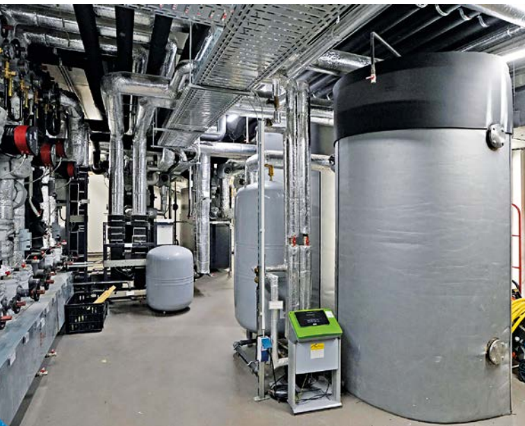
Oben: Wärmepumpenheizung in einem Büsumer Hotel, die zur Effizienzsteigerung große Pufferspeicher nutzt.
