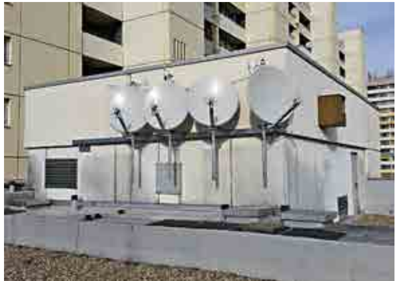
Vier Schüsseln, vier SAT-Positionen - die neue SAT-Anlage ist in Leonberg nun nicht mehr auf dem höchsten Gebäudeteil untergebracht
