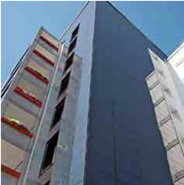
Pionierleistung: Erstmals wurde eine Photovoltaikanlage als Glasvorhangfassade mit einem rahmenlosen Klemmsystem an einem Wohnhochhaus realisiert
