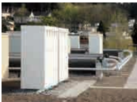
Zürich: Gebäude mit einer zentral auf dem Dach angebrachten Einheit zur Wartung und zum Filterwechsel. Störungen für Mieter werden so minimiert
