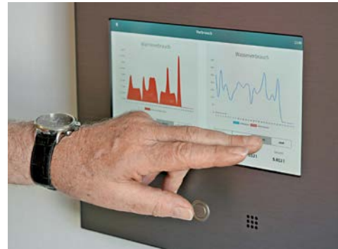
Das Smart-Building- und Smart-Home-System ermöglicht ein digitales Energiemanagement sowie Verbrauchsinformationen für die Mieter
