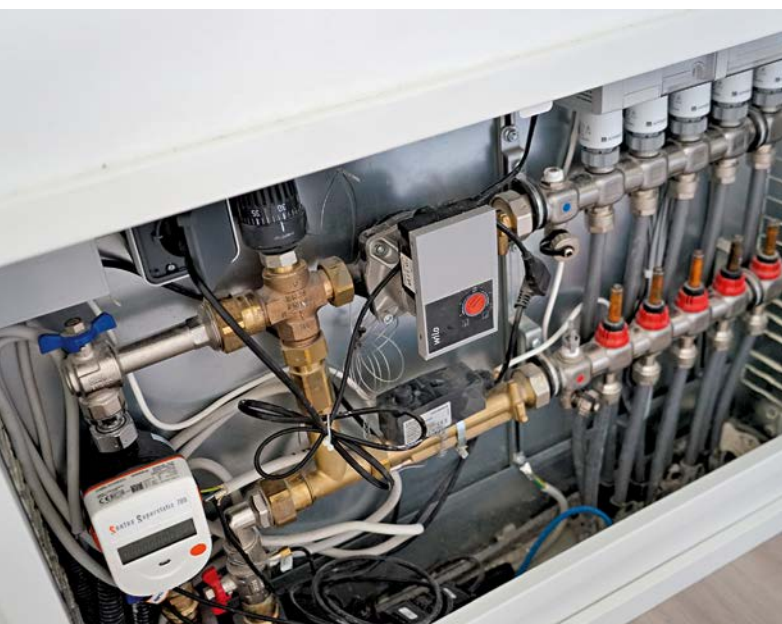
Sensoren und Aktoren machen aus der technischen Gebäudeausstattung ein intelligentes Gebäudesteuerungssystem
