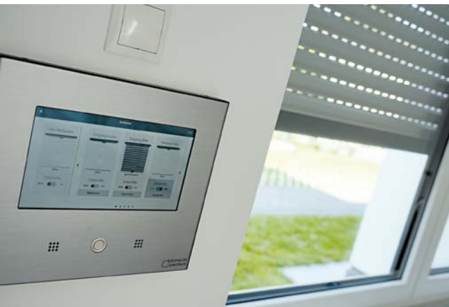
Über den sogenannten Wohnungsadapter ist die Kontrolle und Bedienung einzelner Komponenten möglich
