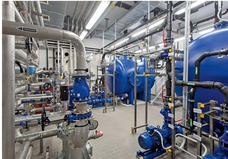
Vakuum-Kompressoren saugen das Abwasser aus den Toiletten der Haushalte in den zentralen Betriebshof von Hamburg Wasser
