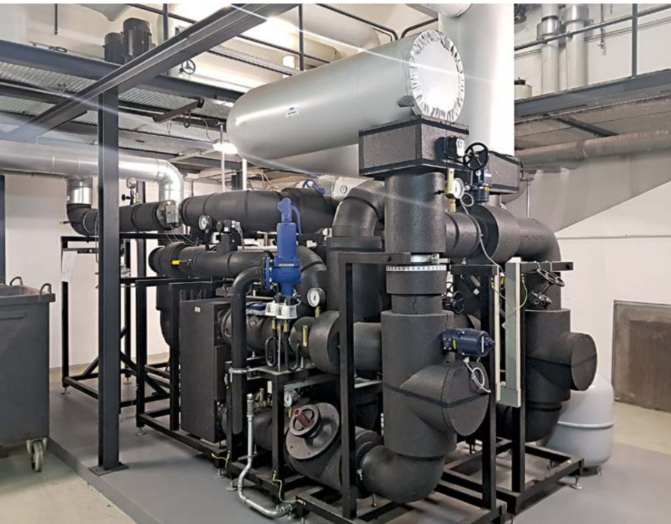
Übergabestation auf dem früheren Standort der Gaskessel
